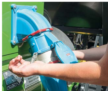
Neben einer Dose f r die Hauseinspeisung bietet das 150-kVA-Aggregat eine zweite 250-Ampere-Dose. Damit der Stecker nicht losvibriert, wird er mit Klammern fixiert.
