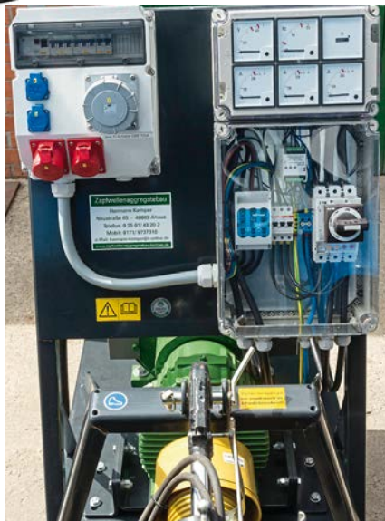
Der gute Blick auf die Instrumente vom Schlepper aus erlaubt das passende Einstellen der Zapfwelldrehzahl. Der Generator-Leistungsschalter ist auf den rechten Kasten montiert.
