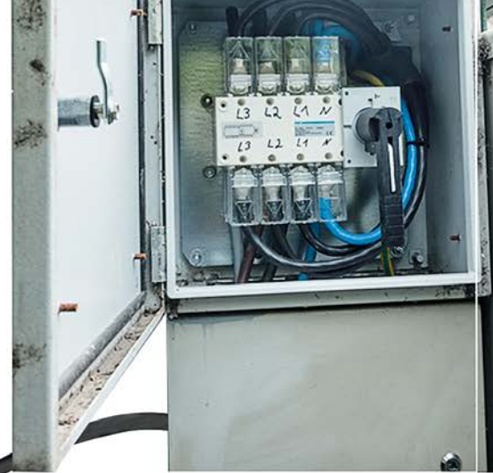
Kemper nimmt seine Aggregate selbst vor Ort in Betrieb. Dazu wird einmal der gesamte Hof ausschließlich mit Notstrom betrieben, um zu sehen, ob alles läuft. Wichtig: Der Einspeisepunkt mit Netztrennschalter muss jedoch bauseitig bereits vorhanden sein.
