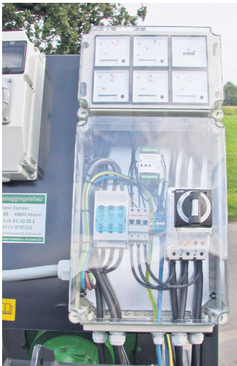
Ein guter Blick vom Schlepper aus auf die Instrumente: Amperemeter, Voltmeter, Frequenzmesser und Betriebsstundenmeßgerät.
